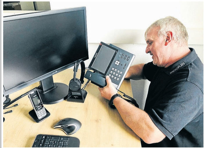
Ein Mitarbeiter der Firma Microplan installiert die neuen Telefone.
